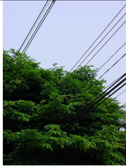
Figura 7: Presença de fiação em copa de pau-brasil, Rua Senador Vergueiro, São Paulo (SP).
