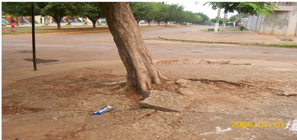
FIGURA 6 -Espécie Caesalpinia peltophoroides , danificando as calçadas das ruas e avenidas de Cacoal, (SILVA, J.L. 2006).
