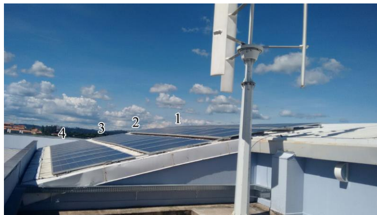
Figura 1 – Vista dos painéis instalados em 4 fileiras.
