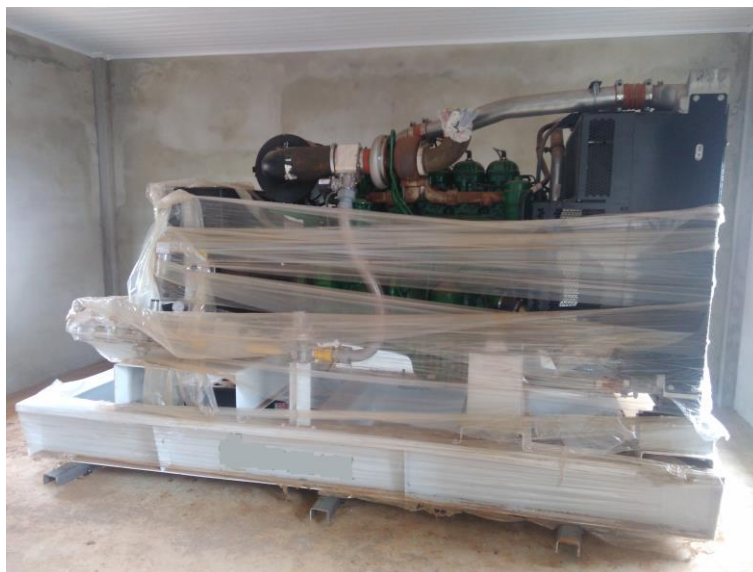
Figura 4 - Grupo gerador adquirido pela propriedade para geração de energia através do biogás
