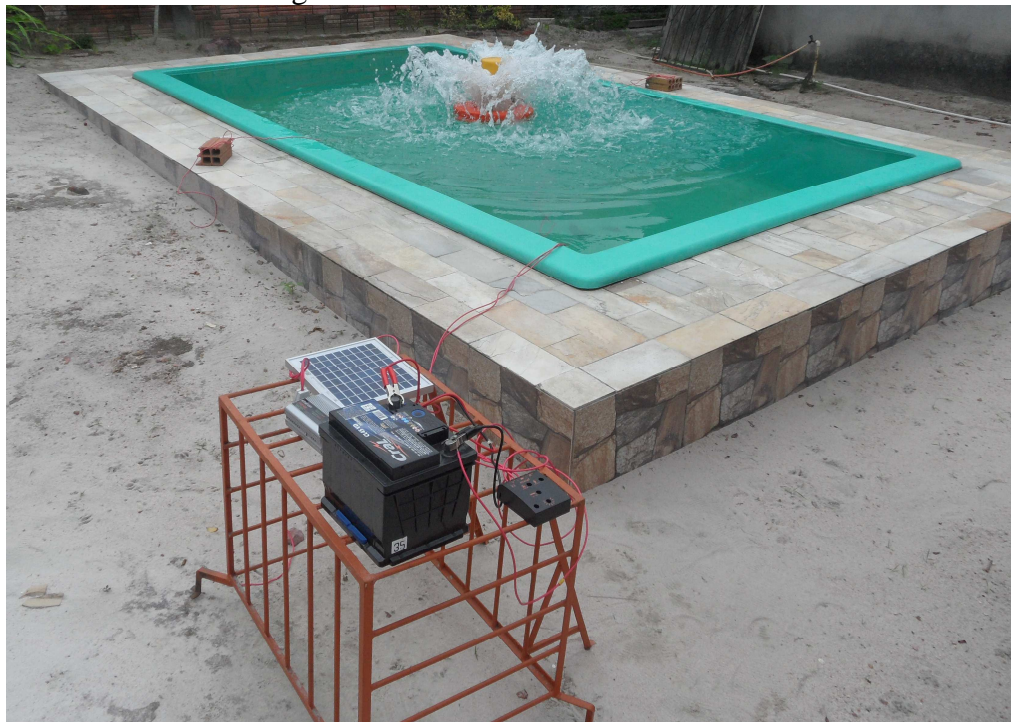
Figura 4 – Funcionamento do Aerador
