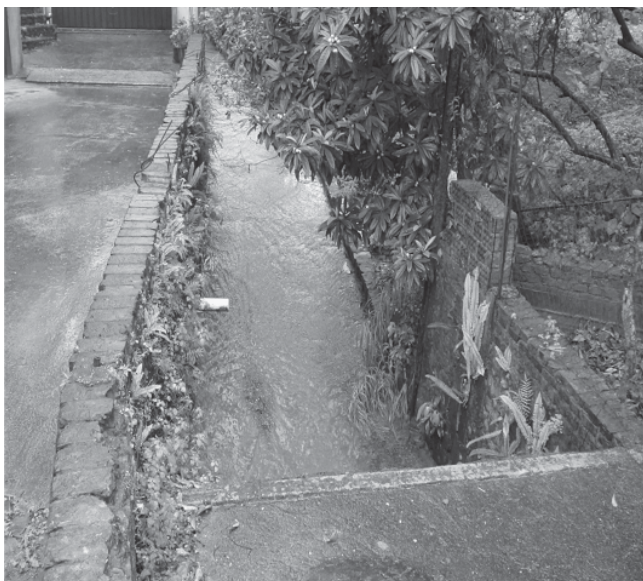
FIGURA 7 - CANALIZAÇÃO MISTA DA SANGA DA ALDEIA, COM ALGUNS TRECHOS PROTEGIDOS COM MUROS E OUTROS COMPLETAMENTE FECHADOS
