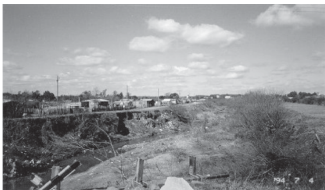
FIGURA 5 - PROCESSO DE EROSIÃO DE MARGEM E ALARGAMENTO DO CANAL NO TRECHO RETIFICADO DO ARROIO CADENA
