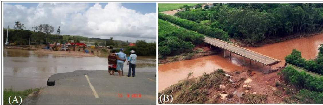
Figura 02 - Exemplos de pontes afetadas pelas enchentes. A) Destruição total da ponte da cidade de Palmares (PE) em 2010 (Fonte: os autores). B) Destruição da cabeceira da ponte sobre o rio Pirapó na PR-317 entre Maringá e Iguaraçu, norte do Paraná (Fonte: jornal O Diário, Maringá, 19/01/2016).
