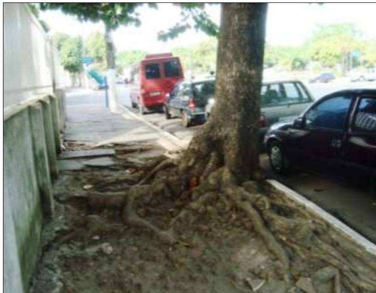
Figura 7: Calçada intransitável, completamente destruída pela raiz, no bairro central da cidade de Macapá, fevereiro 2011.
