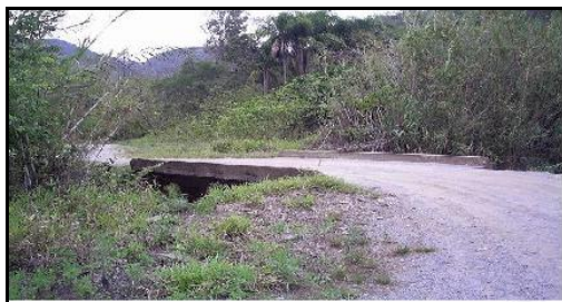
Figura 11. Ponte de alvenaria, rio Rocha, Comunidade do Rocha, Cerro Azul/PR. Trânsito entre a estrada e a Comunidade do Rocha. Fonte: Pesquisa de campo (2006).
