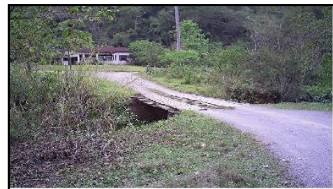
Figura 12. Ponte de madeira, rio Rocha, Comunidade do Rocha, Cerro Azul/PR. Trânsito entre o posto de saúde, o telefone público e residências. Fonte: Pesquisa de campo (2006).
