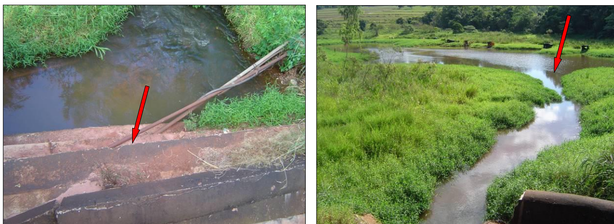
Figura 10: Barragem desativada no médio curso do ribeirão São Tomé e a configuração atual do canal de drenagem
