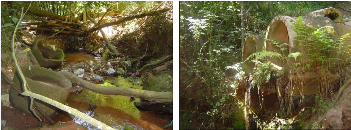
Figura 11: Presença de resíduos sólidos e de galerias pluviais no interior do Parque Municipal do Cinturão Verde no alto curso do ribeirão São Tomé Fonte: Coleta de campo (2008)
