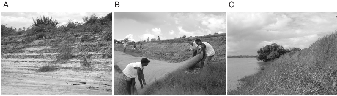
FIGURA 5 - IMPLANTAÇÃO DA BIOENGENHARIA DE SOLOS NO TALUDE MARGINAL DO RIO SÃO FRANCISCO, NO PERÍMETRO IRRIGADO COTINGUIBA-PINDOBA: A) TALUDE ANTES DA INSTALAÇÃO; B) INSTALAÇÃO DO GEOTÊXTIL; C) TALUDE 60 DIAS APÓS A IMPLANTAÇÃO (PERÍODO DE JULHO/2004 A MARÇO/2006)
