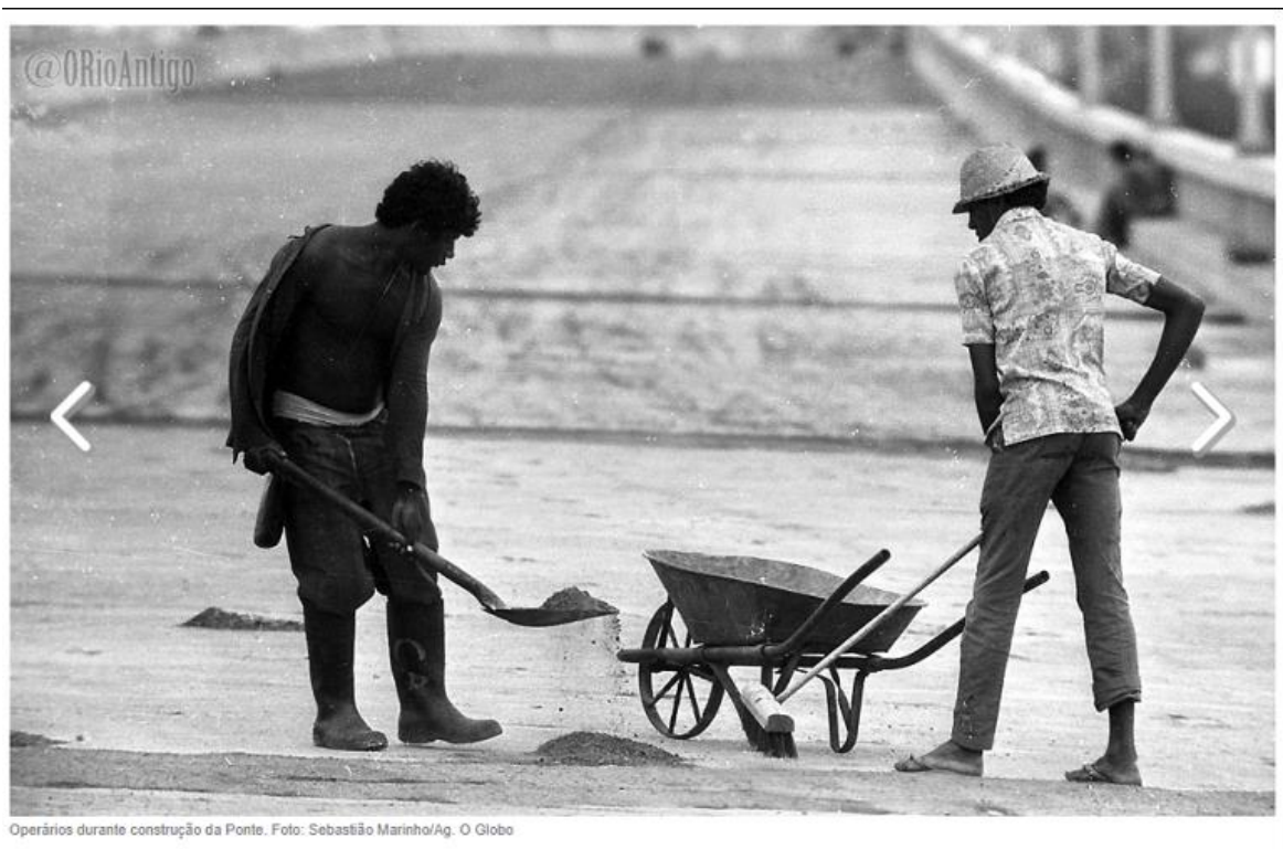
Imagem 1 – Flagrante de falta de itens de segurança pelos operários na construção da ponte Rio-Niterói
