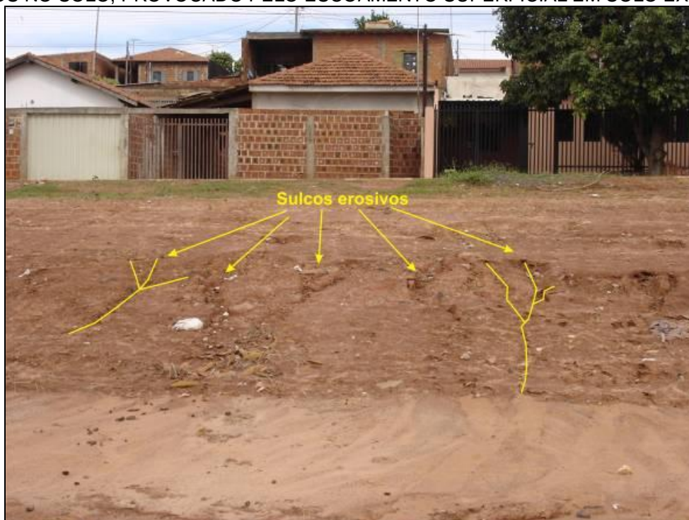
FOTO 02. NO PRIMEIRO ESTÁGIO DO PROCESSO EROSIVO, OBSERVAM-SE PEQUENOS SULCOS NO SOLO, PROVOCADO PELO ESCOAMENTO SUPERFICIAL EM SOLO EXPOSTO.
