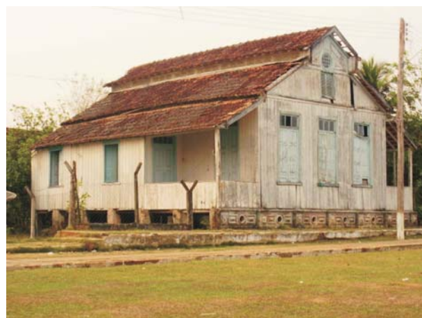
Figura 7 – Este casarão “presenciou” a ascensão e o declínio dos ciclos da borracha, atualmente corre o sério risco de ser levado pelas “terras caídas”. Fonte: Arquivo do autor
