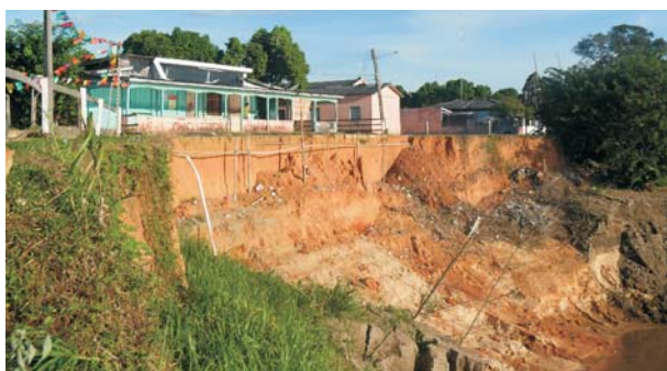
Figura 5 – Vista parcial das “terras caídas” em Calama – maio de 2011. Em comparação com a imagem de setembro de 2010, alguns detalhes podem ser observados: parte da cerca já foi destruída, a calçada não existe mais, praticamente impedindo a passagem dos pedestres, e o cano de água que estava parcialmente exposto, já está encostado com estacas, expondo o segundo cano de água. A paisagem é desoladora, principalmente para os comerciantes que foram obrigados a desocupar a área. Esta é uma das construções antigas com alto valor histórico. Fonte: Arquivo do autor
