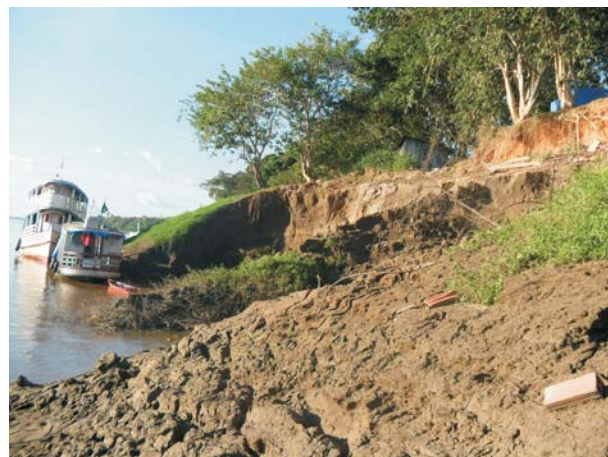
Figura 6 – Vista parcial da margem em frente à Igreja – maio de 2011. Observam-se os sinais de um escorregamento recente e a fragilidade do local, totalmente suscetível a novos escorregamentos. O que ocorrerá provavelmente na próxima cheia/vazante. Fonte: Arquivo do autor
