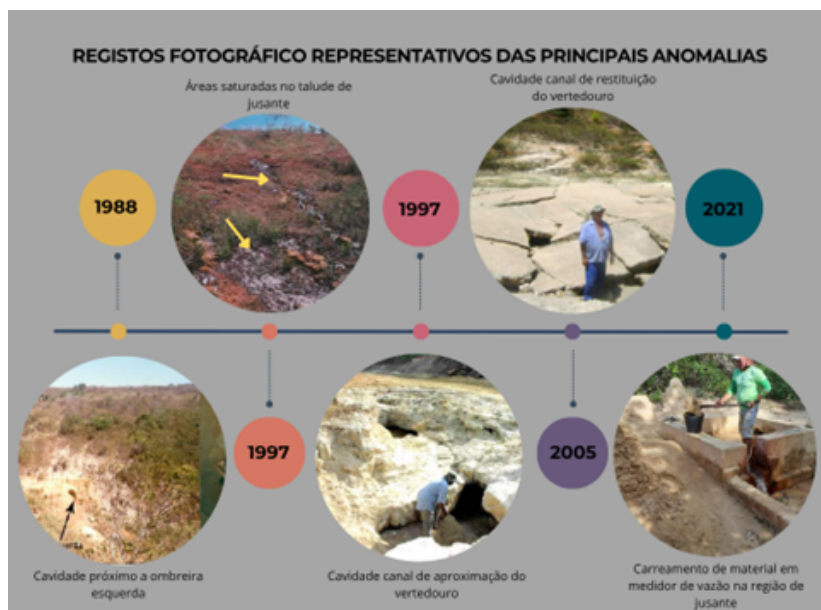
Figura 8. Histórico das Anomalias Identificadas na Barragem Jaburu I. Fonte: Elaborado pelo autor com base em dados da COGERH (2021).
