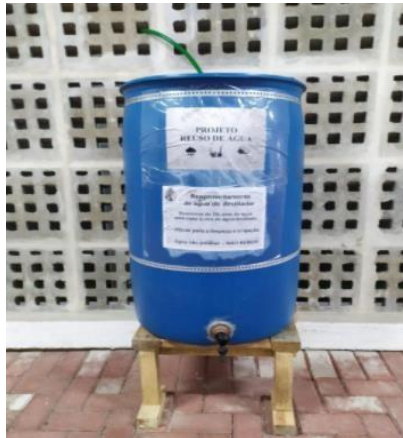
Figura 2 – Sistema de captação de água para reutilização no projeto
