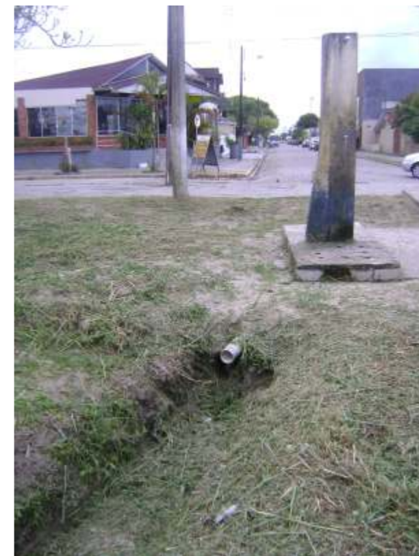
Figura 15 – águas servidas erodem a área de restinga. Foto do autor, outubro de 2013.
