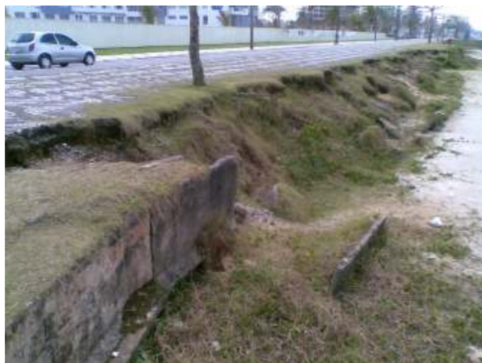
Figura 4 – trecho de praia em Matinhos/PR, com calçadão e muro de arrimo afetados pelo mar. Note-se a ausência da restinga. Foto do autor, outubro de 2013.
