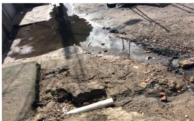
FIGURA 2. ESGOTO A CÉU ABERTO NO BAIRRO DA IPUTINGA.
